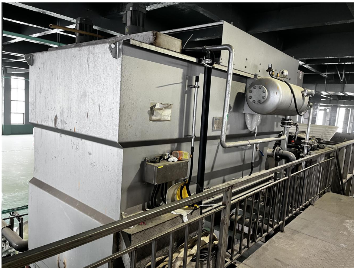
生产废水处理设施
