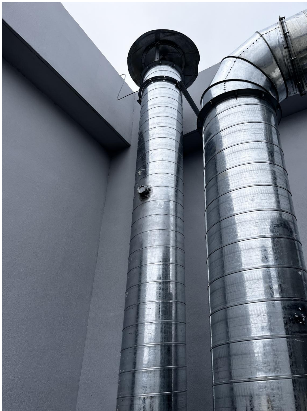
湿磨废气排气筒
